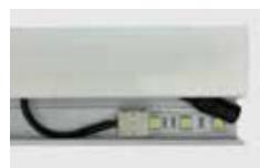
Espacio para alojar el cableado Space for holding cables
